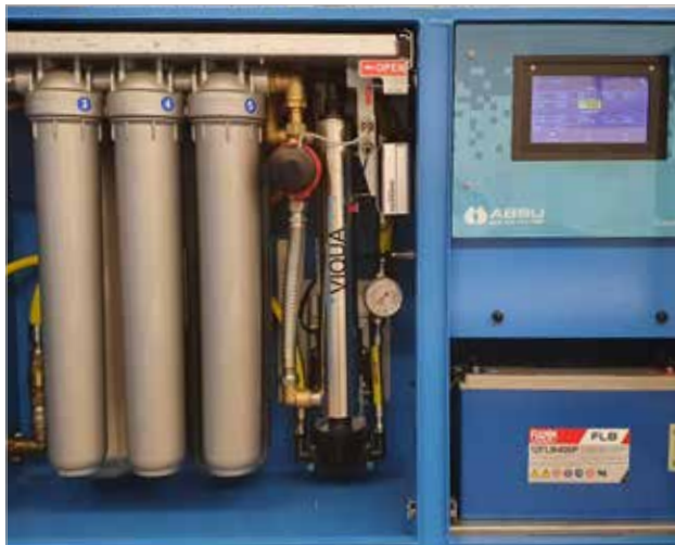
Wasseraufbereitungsanlage Water treatment plant
