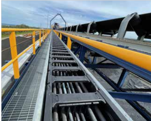
Förderanlage Conveyor system
